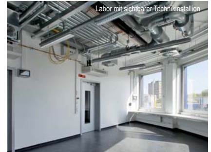
Labor mit sichtbarer Technikinstallation
